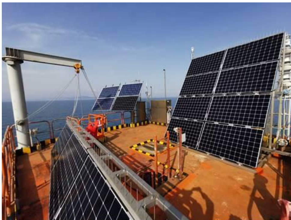
(Moduli fotovoltaici montati sulla piattaforma)
